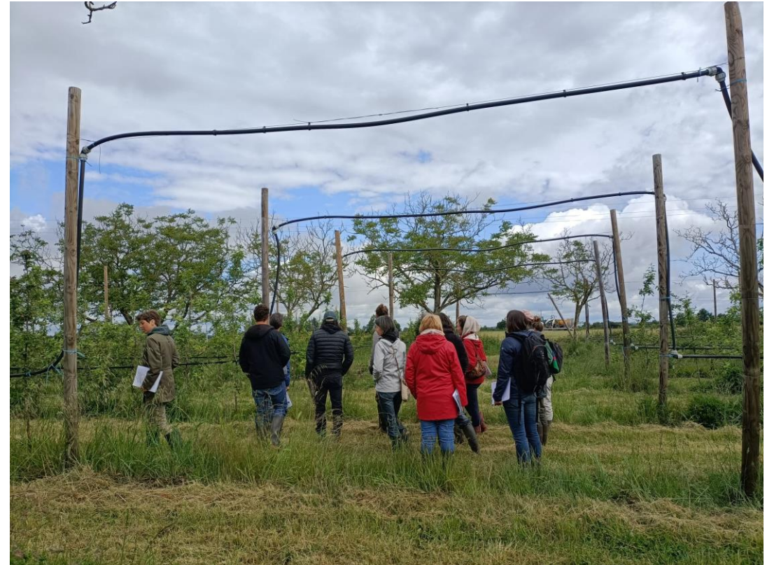
Microaspersion sur 300m, perte de charge entre les 2 parties de la ligne.
